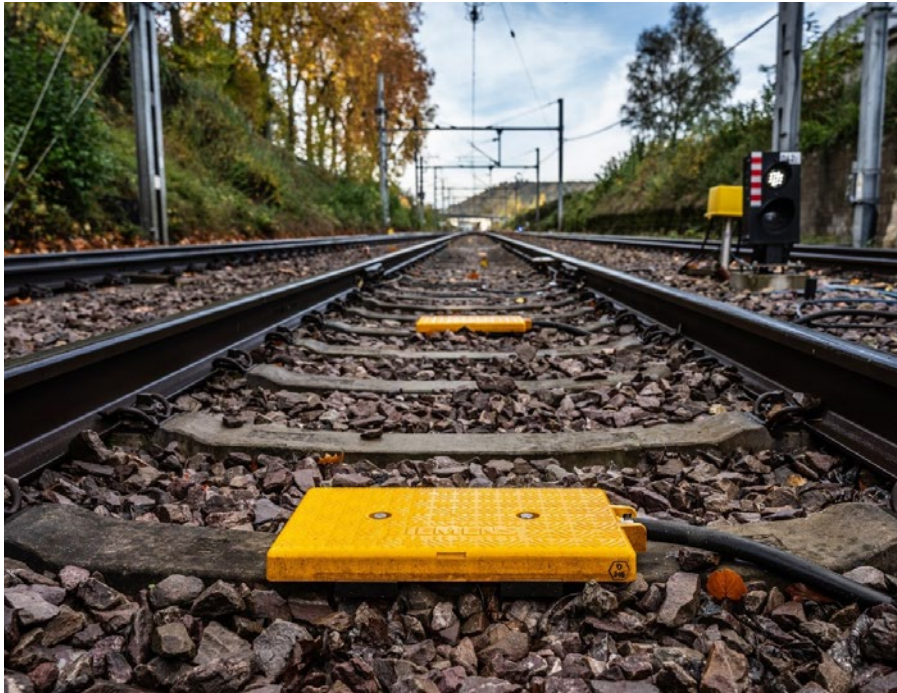
3: Schaltbare Balisengruppe am fahrzeigenden Lichtsperrsignal
